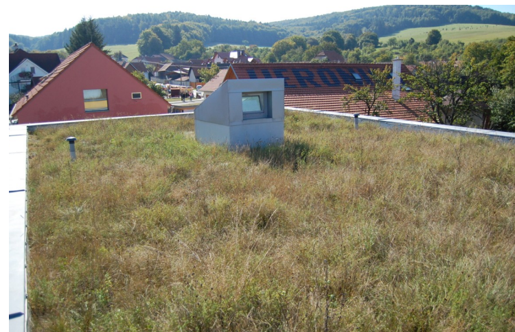
zelená střecha na v Hostětíně (Centrum Veronica)
