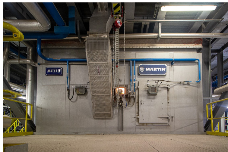
spalovací kotel v Malešicích u Prahy
